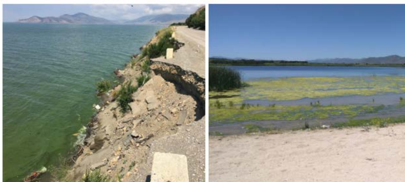
Рисунок 1. Процесс абразии разрушает трассу М-4 (слева), заболачивание берега в районе озера Гилли на восточном побережье Севана (справа). Фото автора.
